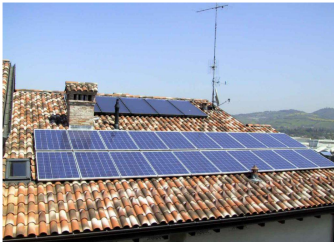
Pannelli solari sul tetto di un'abitazione e, a destra, operai al lavoro per installare un impianto
